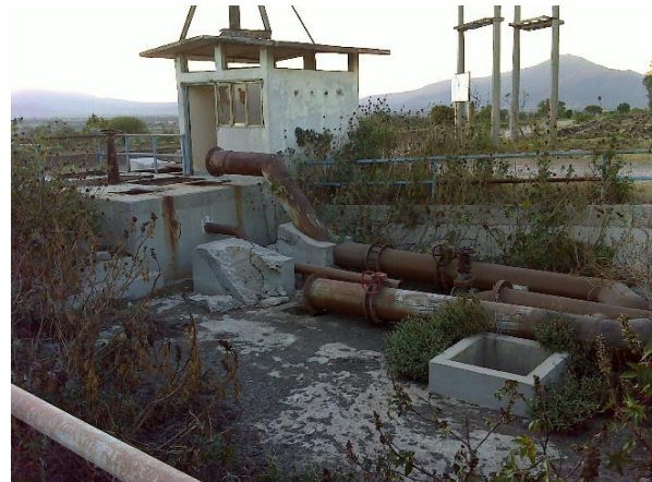
Figura 3.168 Fotografía, maquinaria del sistema de bombeo. Con la obra se beneficiaron 1146 usuarios, tomada por Lilian Nallely Velázquez Cervantes, 4 de abril de 2017, cerro del Xicuco, archivo personal.
