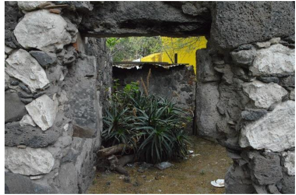
Figura 3.187 Fotografía, casa de Armando Cornejo, se encuentra en mal estado de conservación, ha perdido el techo y secciones de muro. Tomada por Lilian Nallely Velázquez Cervantes, 31 de marzo de 2017, comunidad de Mangas, archivo personal.
