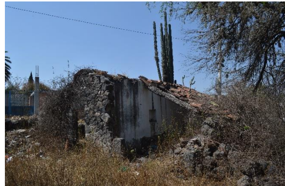
Figura 3.183 Fotografía, casa de piedra basáltica, ha perdido la techumbre y secciones de muro, tomada por Lilian Nallely Velázquez Cervantes, 26 de febrero de 2018, colonia Centro, archivo personal.
