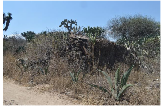
Figura 3.198 Fotografía, casa de piedra de la familia Cervantes Ángeles, su estado de conservación es regular, ha perdido la techumbre de teja y sobre sus muros están creciendo vegetación, tomada por Lilian Nallely Velázquez Cervantes, 24 de febrero de 2018, comunidad de Huitel, archivo personal.
